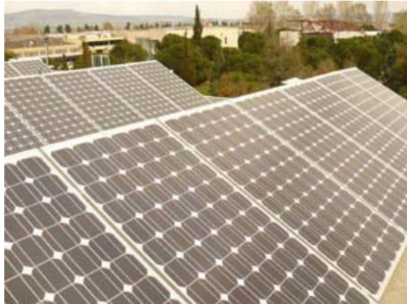
Φωτοβολταϊκός Σταθμός 9,57 KW στο Κατάστημα της Τράπεζας στη ΒΙΠΕ Σίνδου
