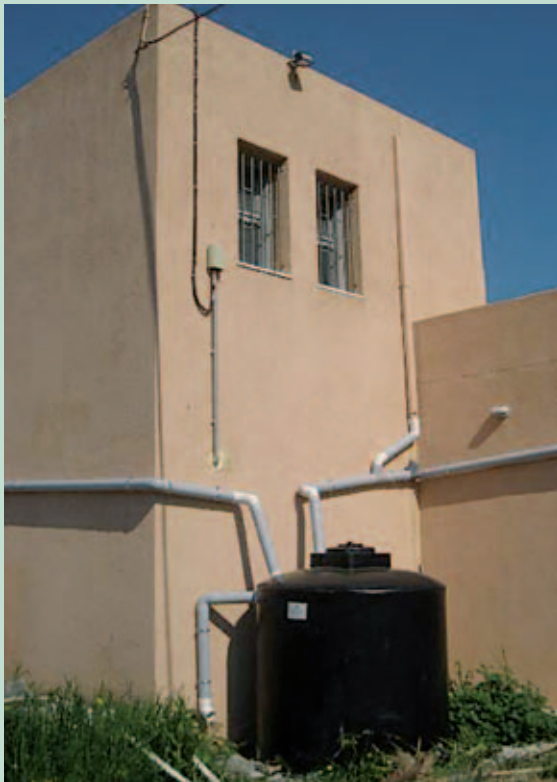
Το σύστημα συλλογής βρόχινου νερού στο Κατάστημα της Τράπεζας Πειραιώς στην Κέα.
