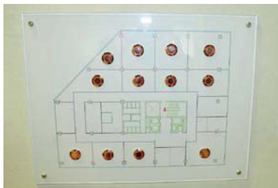
Πίνακας ελέγχου και διαχείρισης φωτισμού σε έναν όροφο από το Κτήριο Διοίκησης της Τράπεζας στη Λ. Συγγρού 87.
