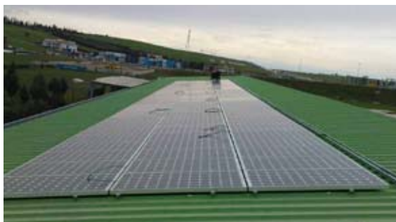
Φωτοβολταϊκός Σταθμός 19,285 KW στο κτήριο αποθήκης της Τράπεζας στο Ωραιόκαστρο
